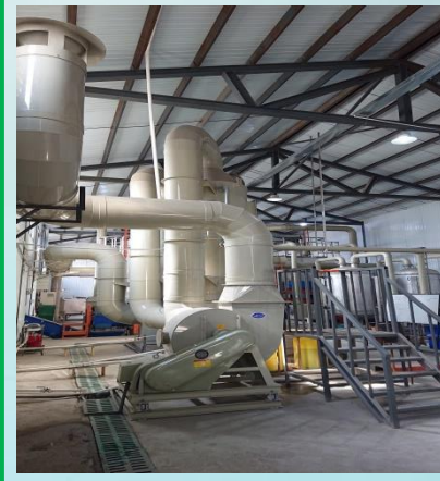
ระบบสกรัมกำจัดกลิ่นและระบบเดาน้ำ เย็น
