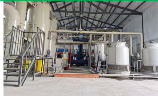
Hệ thống tháp rửa và tháp làm mát khử mùi
