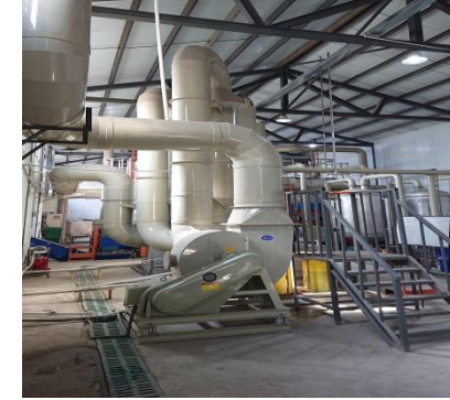
Hệ thống thu gom bụi khô
